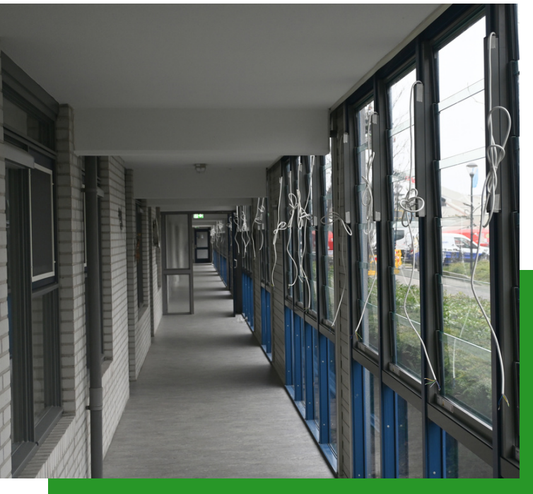
*De geplaatste elektrische lamellen
