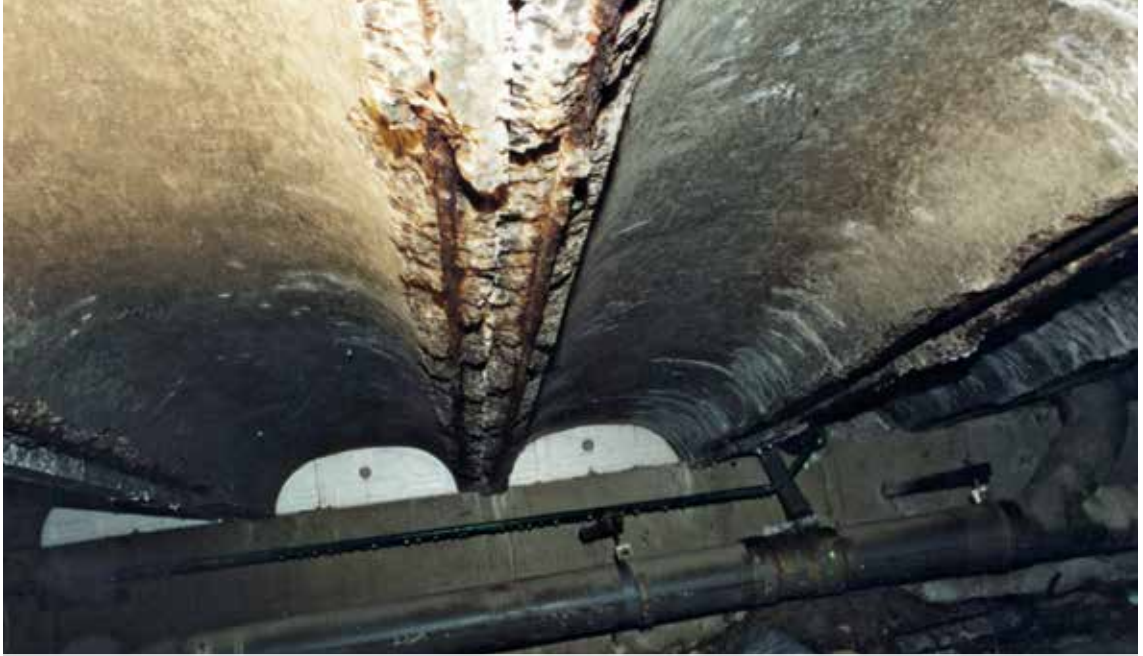
Typische schade kwaaitaalvloer
